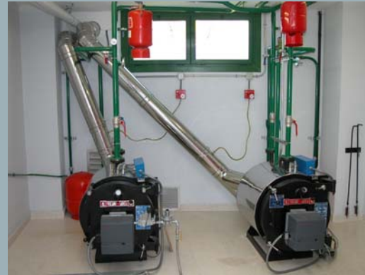
Sala calderas industrial
