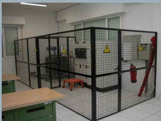
Centro de transformación
